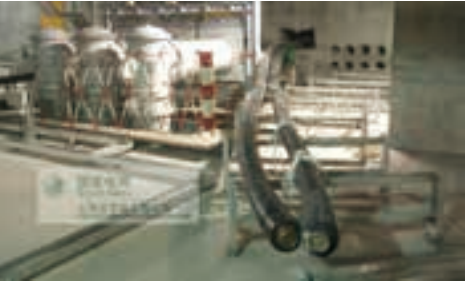
图14 从电缆隧道引致站内的高压电缆
