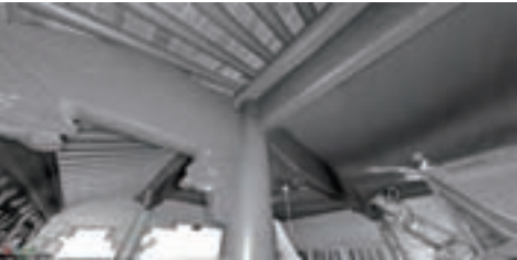
图6 3D激光扫描点云模型（破损查找）
