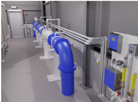
水処理施設における凝集剤注入
