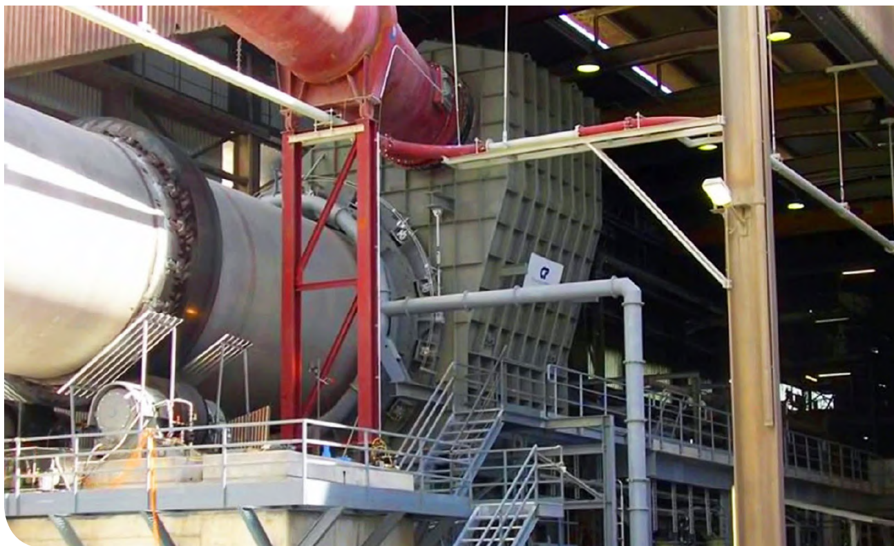
スイスの Holcim Intervaz Cement Plant の ETA Cooler は、サッカー場の半分ほどの大きさがある巨大な装置 [提供: Claudius Peters]
